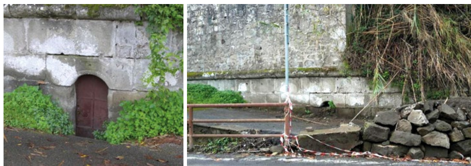
Fig. 22 e 23 – A sinistra, la porticina, che dà accesso all'incile sulla strada circumlacuale, prima della frana. A destra, l'accesso all'emissario è impedito, da anni, dalla frana che ha tombato l'ingresso
